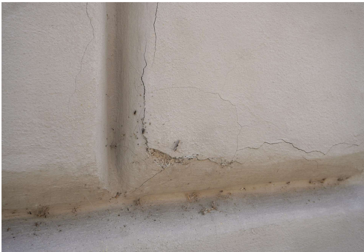
Obr. 18: Druhotná barevná vrstva na bosáži na nároží budovy je v některých částech popraskaná a odděluje se od podkladu.
